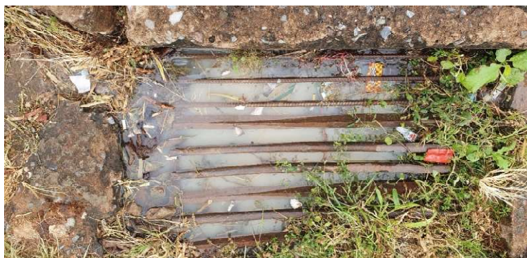
Figura 9: Bueiro entupido com terra, vegetação e resíduo.
